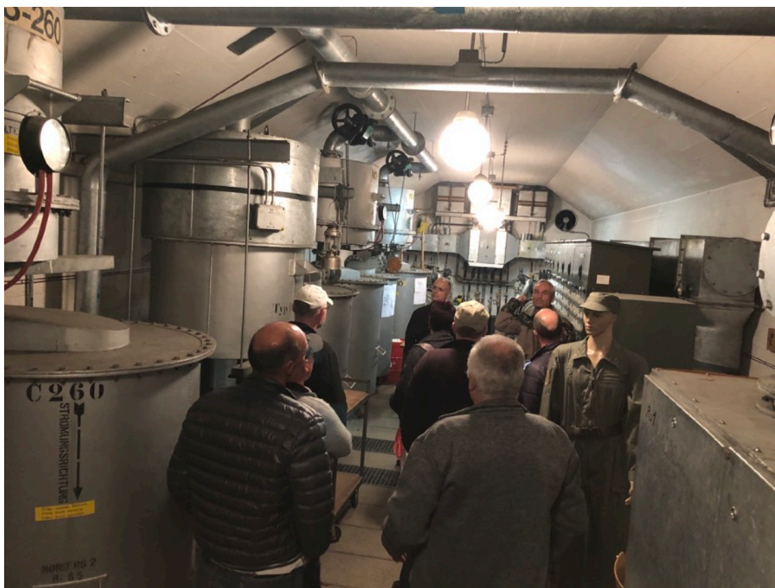
Technikraum mit einer mehrstufigen Luftfilteranlage und 2 Stück Sulzer-Diesel-Gegenkolben-Stromerzeuger, sowie einem grossen Schaltschrank und Dieseltanks (oberhalb Bildmitte).
